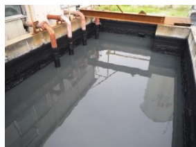
冷却塔ピット
