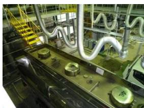
タンクローリー洗浄設備
