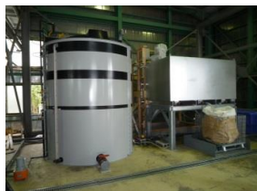
廃水処理設備
